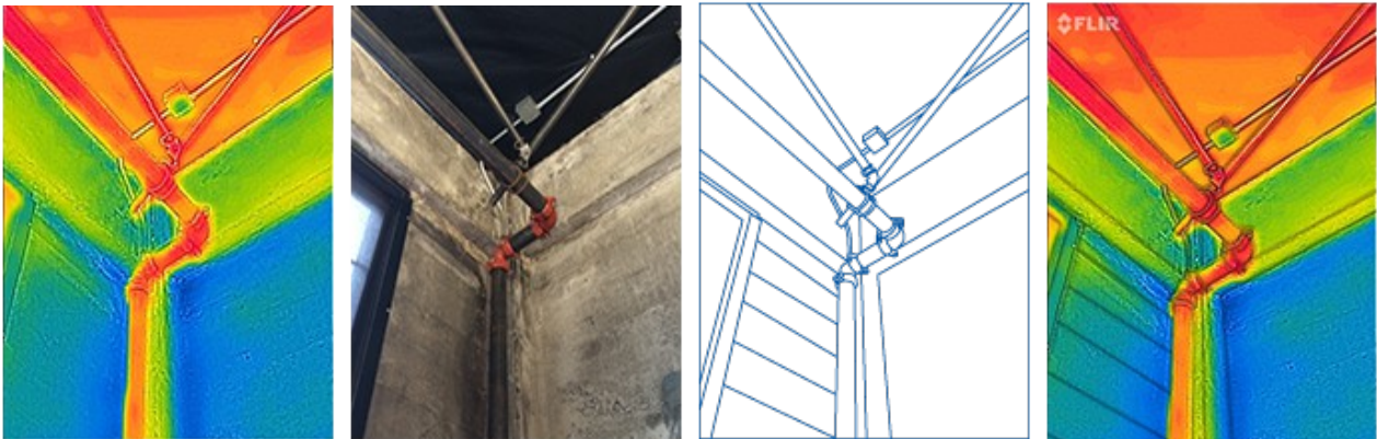
IMMAGINE TERMICA IMMAGINE NEL VISIBILE DETTAGLIO ESTRATTO IMMAGINE COMPOSTA
